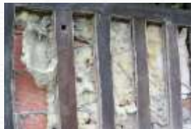
Mauvais vieillissement d'isolant
