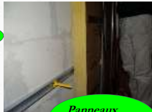
Panneaux entre rails
